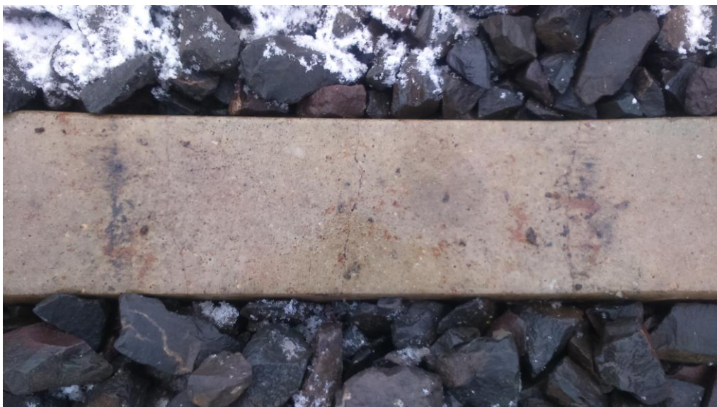
Rysunek 7. Uszkodzony podkład kolejowy na skutek przeciążenia w części środkowej – wyraźnie widać regularne, symetryczne zarysowania.
